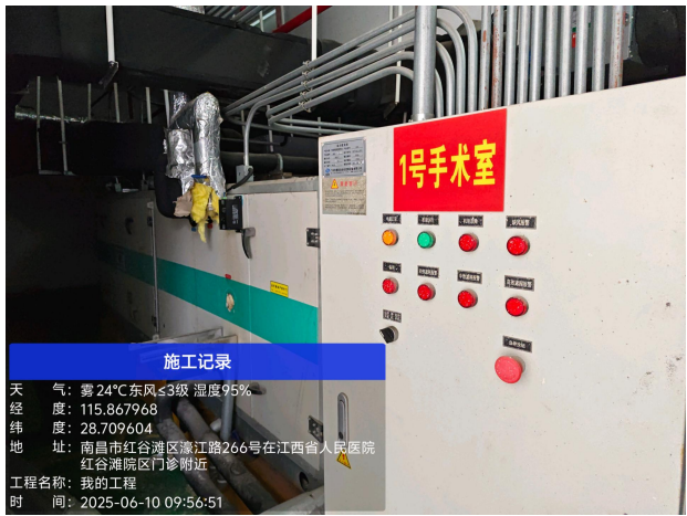
拟建 DSA 机房楼上设备层
