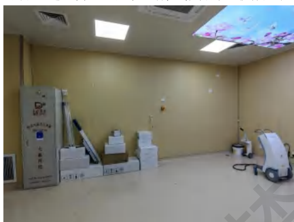
治疗室西墙设置 1 个急停按钮
