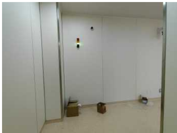
治疗室迷道内入口处设置剂量报警灯、视频监控
