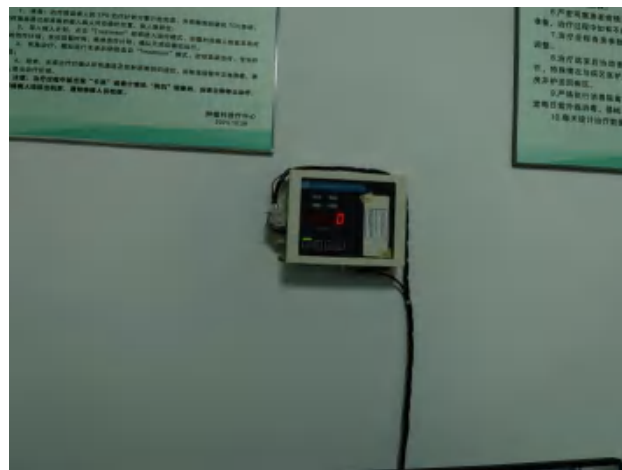
固定式剂量监测报警仪显示器安装于控制室墙上
