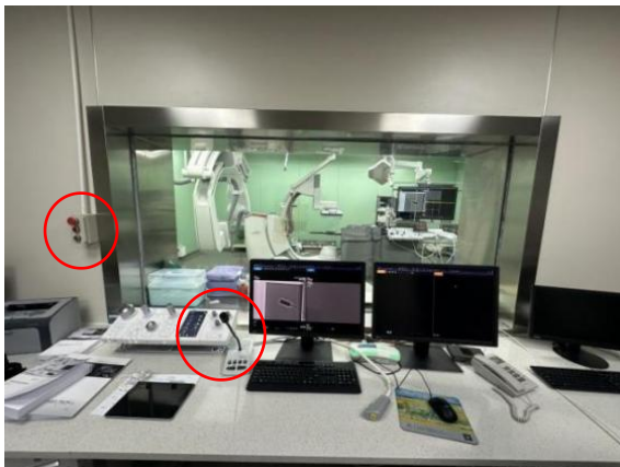
对讲装置和控制室急停按钮
