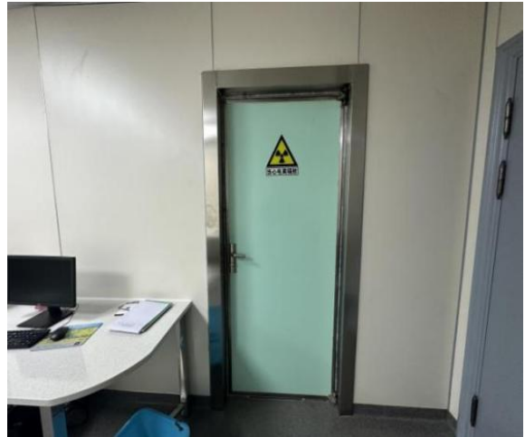
工作人员进出防护门和电离辐射警告标志
