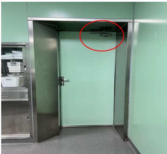
污物通道防护门闭门装置
